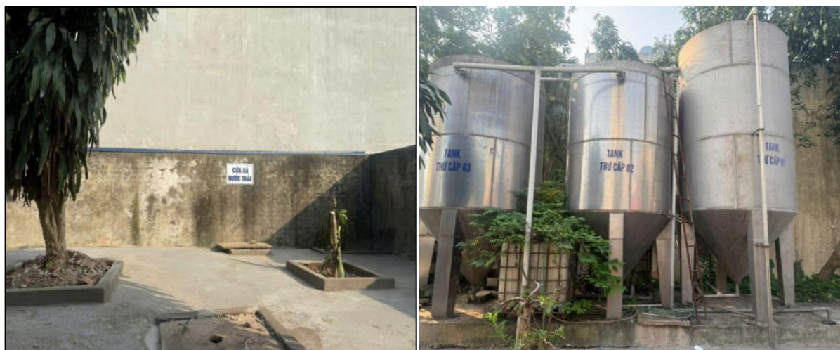
Hình 12. Một số hình ảnh của Trạm xử lý nước thải
